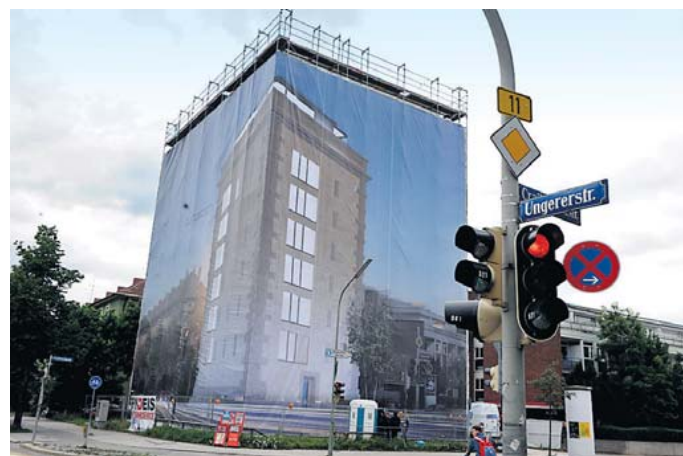
Luxus-Apartements statt Bomben-Zuflucht: Im alten Bunker an der Ungererstraße sollen bis zum Frühjahr kommenden Jahres Wohnungen entstehen. FOTO: STEPHAN RUMPF
